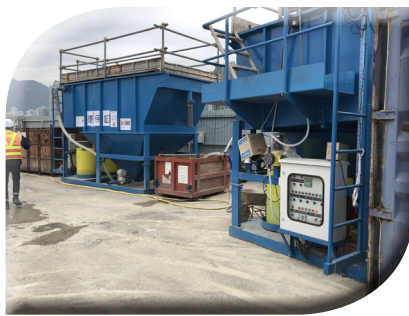
使用污水處理裝置
