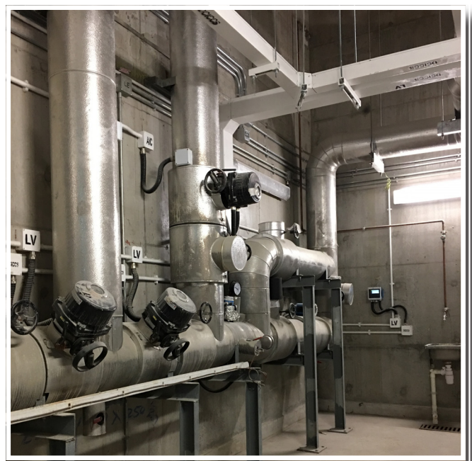
啟德站的區域供冷系統用戶支站
