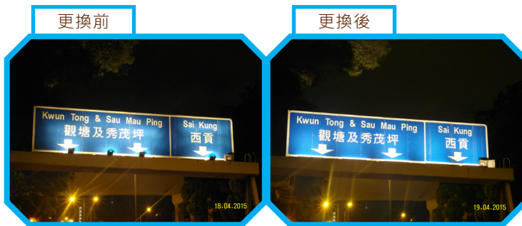
使用發光二極管直條洗牆燈 前後的高架標誌
