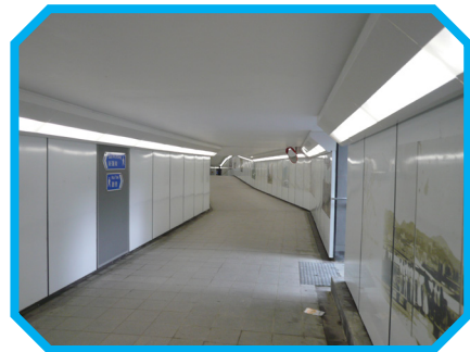
隧道內的發光二極管燈具
