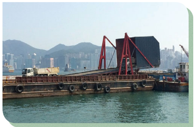
啟德躉船轉運站的卸泥大堂
