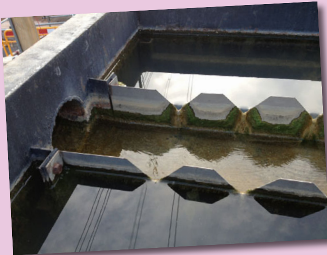
廢水處理設施
