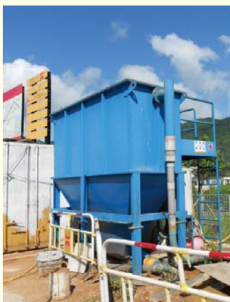
工地的廢水處理設施
