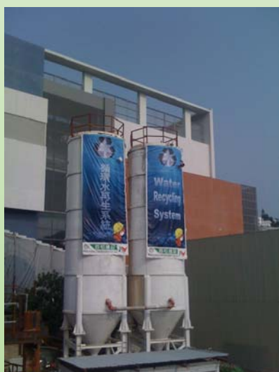
南風道隧道入口安裝的建築污水處理及循環再用設備
