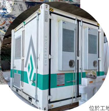
位於工地的能源儲存系統
