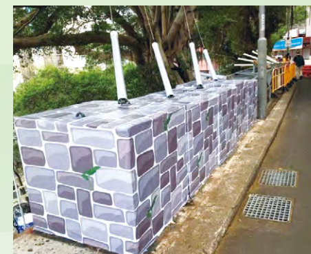
設有樹木拉纜和混凝土方塊的樹木支撐系統
