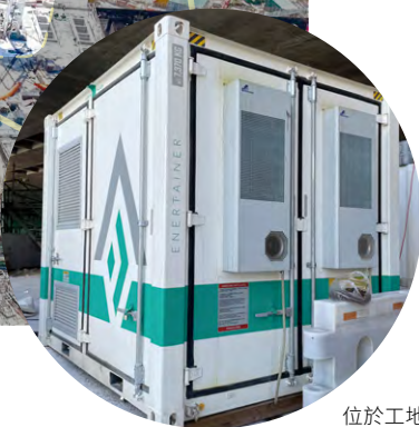
位於工地的能源儲存系統
