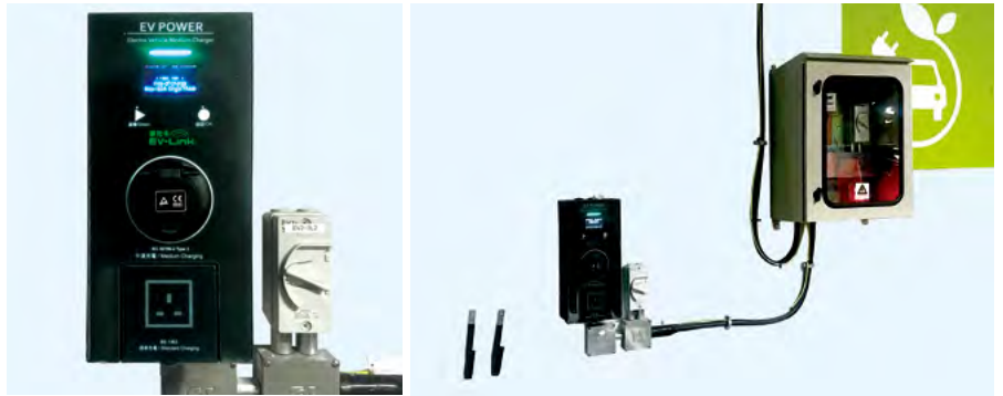
設於工業貿易大樓的全新 32A 中速充電設施
