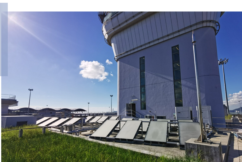
▲ 警察基地的光伏發電板
