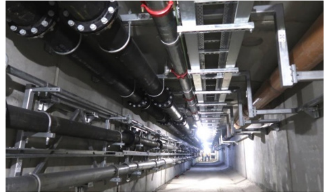
完成安裝的公用設施
