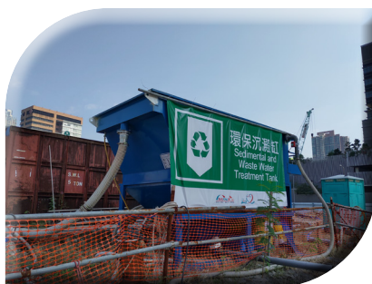
使用污水處理裝置
