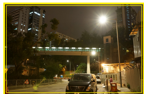
葵喜街— 更換LED燈後
