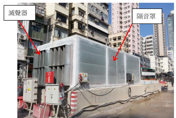
馬頭圍站工程的隔音罩及減聲器
