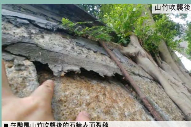
■ 在颱風山竹吹襲後的石牆表面裂縫
