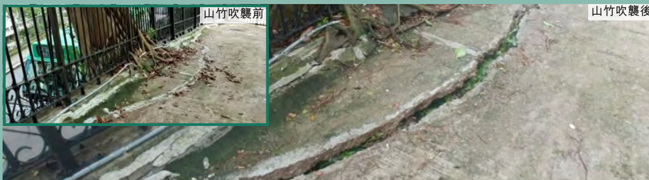
■ 颱風山竹吹襲後明顯增大的石牆裂縫
