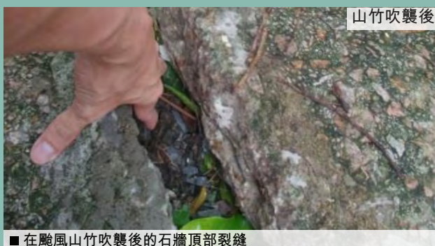
■ 在颱風山竹吹襲後的石牆頂部裂縫
