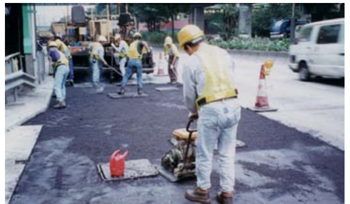
在快速道路上鋪設承重層 Laying of base course on in High Speed Road
